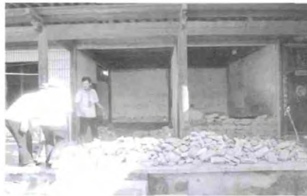
图 1 木架与砖墙房屋震害
