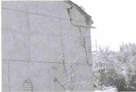
图 4 低烈度区的砖墙房屋震害
