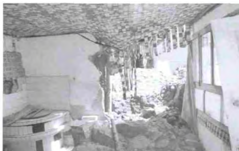
图 2 木架与土坯墙房屋震害
