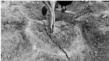
图 5 7# 微型桩的破坏
