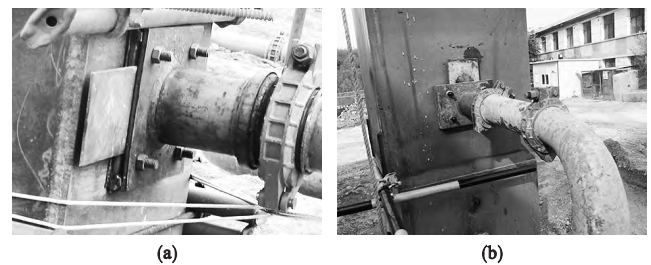
图 3 钢管混凝土顶升截止阀
